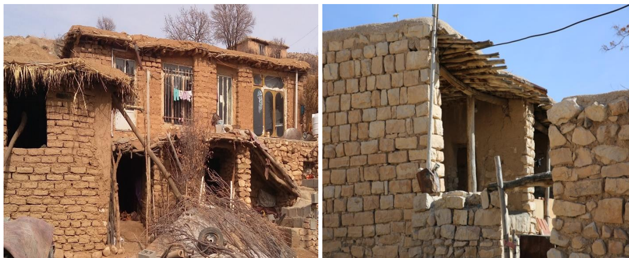
شکل ۴. تصاویر خانه‌های غیر مقاوم در برابر بلایای طبیعی روستاهای بوژان و گورگاووان استان کرمانشاه
