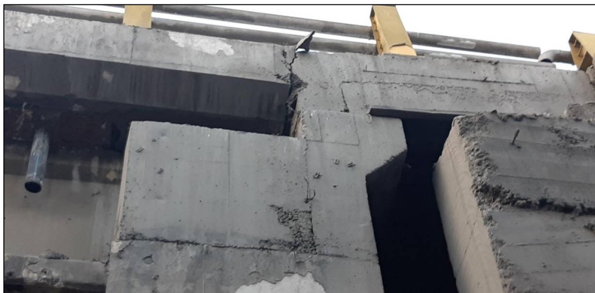
شکل ۴- اثر احتمالی فرونشست زمین بر پل واقع در جنوب تهران
