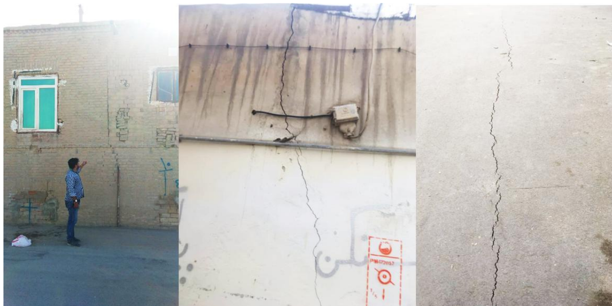
شکل ۵- اثر احتمالی فرونشست زمین بر تعدادی از ساختمان‌ها در مناطق جنوبی تهران
