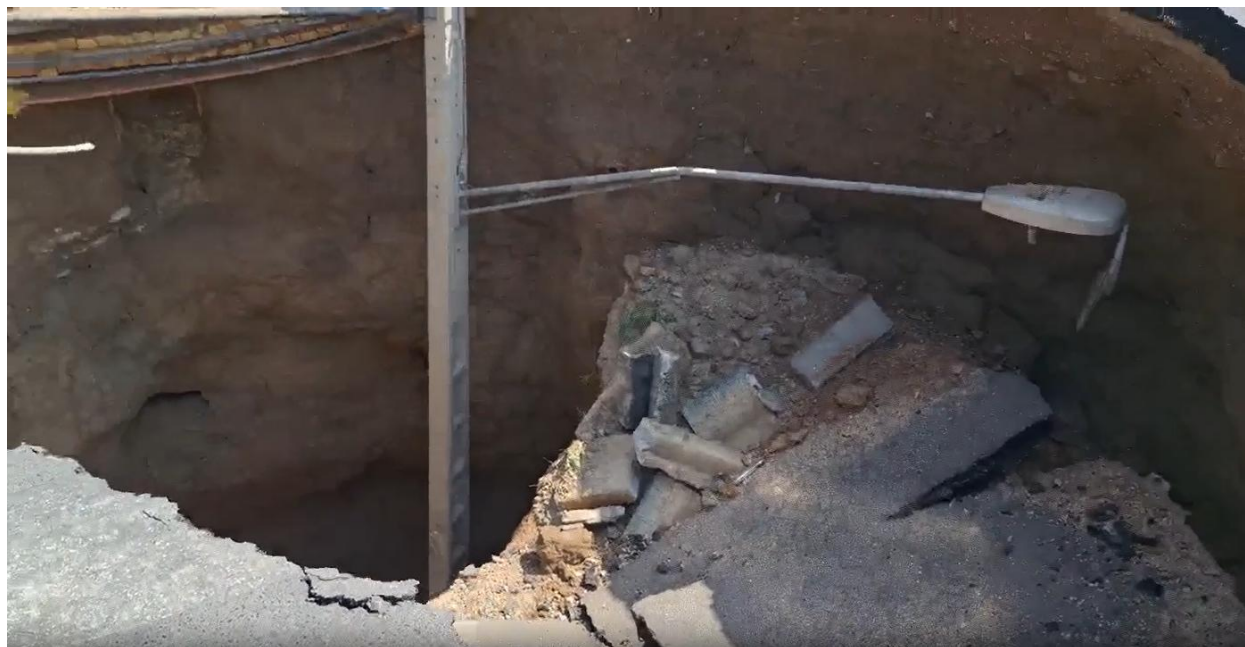
شکل ۷- حفره و مقطع خاک و تیر برق فروافتاده در فروچاله خیابان هشت بهشت (برگرفته از کلیپ خبرگزاری فارس)
